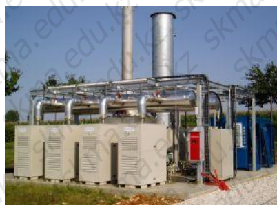
Рисунок 15. 3 – Общий вид микротурбинные электростанции
